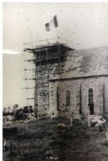
Photographie appartenant à Mme Pain montrant le clocher de Siouville démonté à l'aide d'un échafaudage
