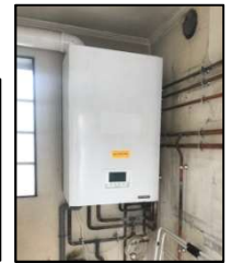
Chaudière à gaz
